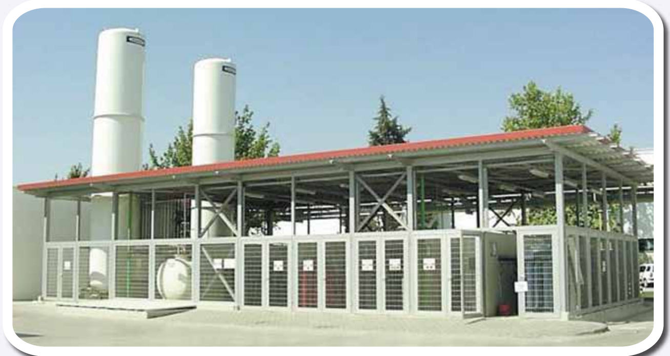
Bosch Bursa "Bu 104" Gaz ve Tank tesisleri tüm mekanik tesisatı ve bina otomasyonu. Mechanical installations and building automation systems of Bosch Bursa "Bu 104" Gas ve Tank Foundation's.
