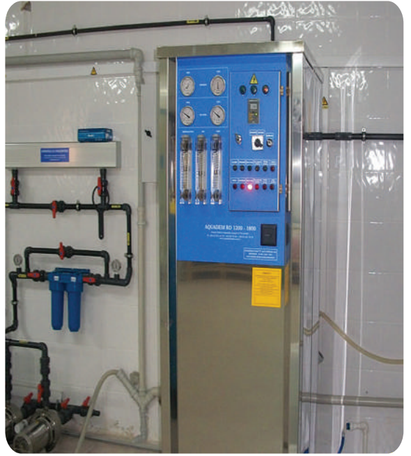
Kahramanmaraş Diyaliz Merkezi tüm mekanik tesisatı. Mechanical installations of Kahramanmaraş Dialysis Center.
