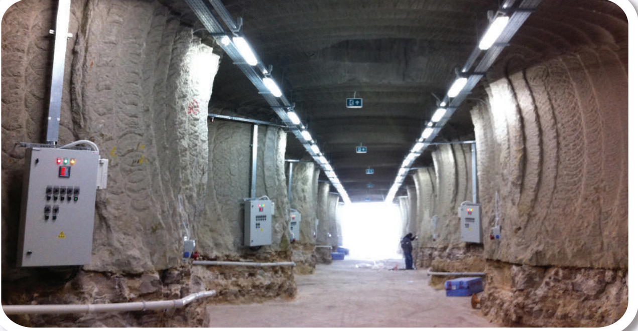
Kütahya yeraltı soğukoda depoları. Kütahya underground storage facilities cooling systems.
