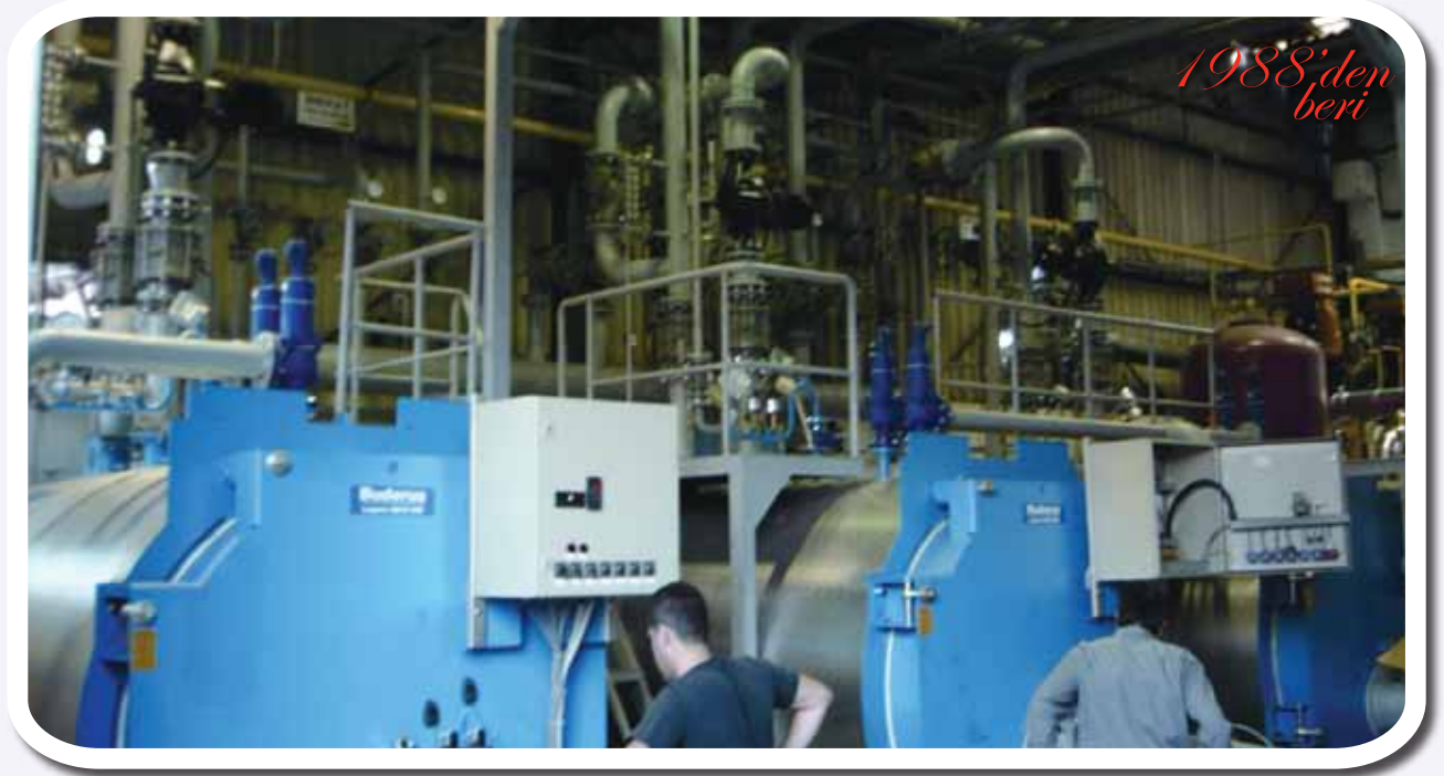
Bosch Bursa Fren Fabrikası ısı merkezi kızgın su ve kızgın yağ sistemi tüm mekanik ve otomatik kontrol tesisatı. Mechanical installations and automatic control systems of Bosch Bursa Brake System factory super heated water & oil systems.
